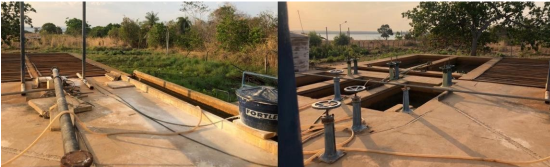
Figura 3 - Estação de Tratamento de Água
