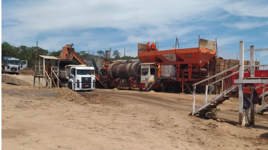
Figura 4 – Usina de fabricação de AAUQ e CBUQ
